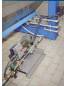
Válvula motorizada y caudalímetro.
