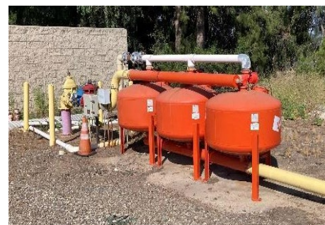
Figura 6: El área alrededor de infraestructura crítica, como los pozos, debe mantenerse libre de vegetación y otros materiales combustibles.
