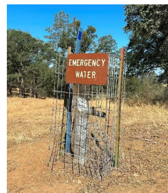
Figura 17: Rotule claramente todas las fuentes de agua de emergencia con señalización reflectante.
