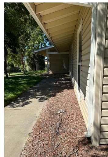
Figura 7: Uso de acolchado de roca alrededor del edificio en la Zona Cero.
