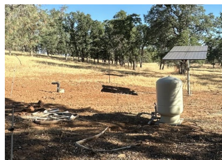
Figura 14: Los pozos y tanques pueden utilizarse para recargar las cisternas y las unidades de bomberos durante un incendio.
